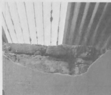
Foto 2: Se realizara mejoramiento de pared de block ya que se esta cayendo el repello al adobe y presenta peligro para los alumnos y docentes.
