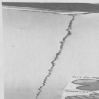
Foto 1: Se realizara mejoramiento de pared de block, debido que es de adobe, se encuentra en mal estado y presenta peligro para los alumnos y docentes.
