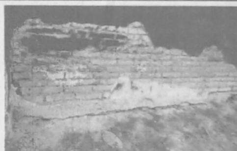
Foto 4: Se realizara mejoramiento de pared de block debido que es de adobe y presenta un riesgo de peligro para los alumnos y docentes.
