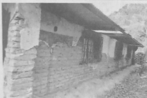
Foto 3: Se realizara mejoramiento de pared debido que presenta agrietamiento en las paredes por lo cual representa un grave riesgo para docentes y alumnos.
